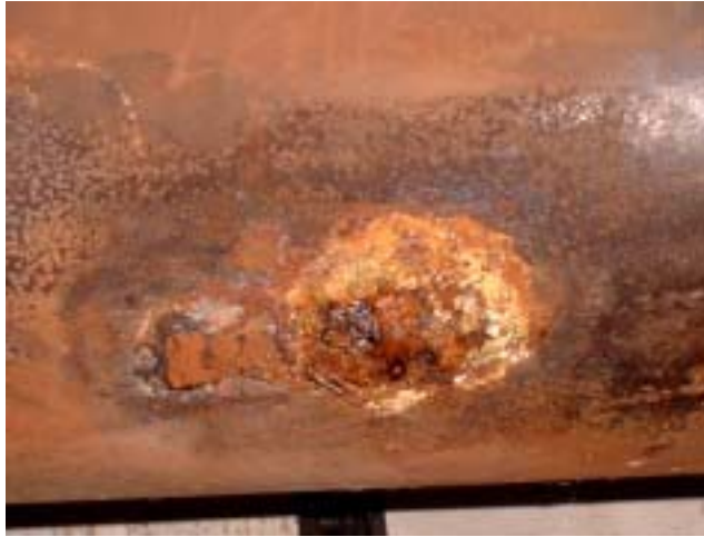
Patología por corrosión anódica debida a corrientes vagabundas.
