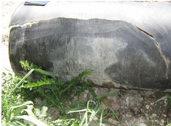
Rotura de tubería de fundición por presencia de aire ocluido. Rotura con explosión y proyección de material de tubería.
