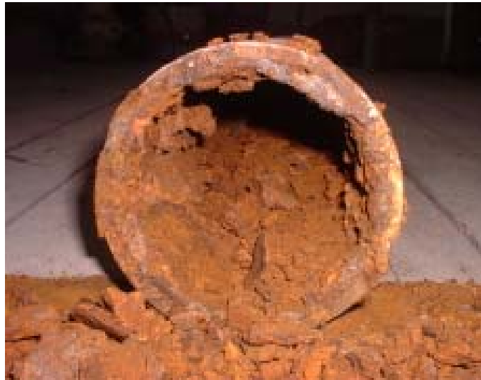
Incrustaciones en tubería de fundición
