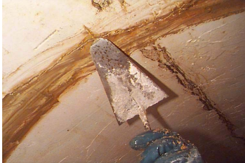
Fisura en la tubería por conexión ejecutada defectuosamente
