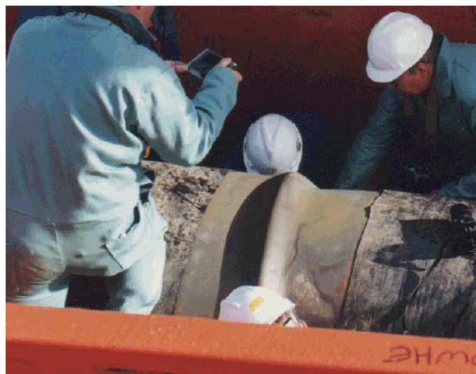
Colapso por incremento de temperatura, sin compensadores de dilatación.
