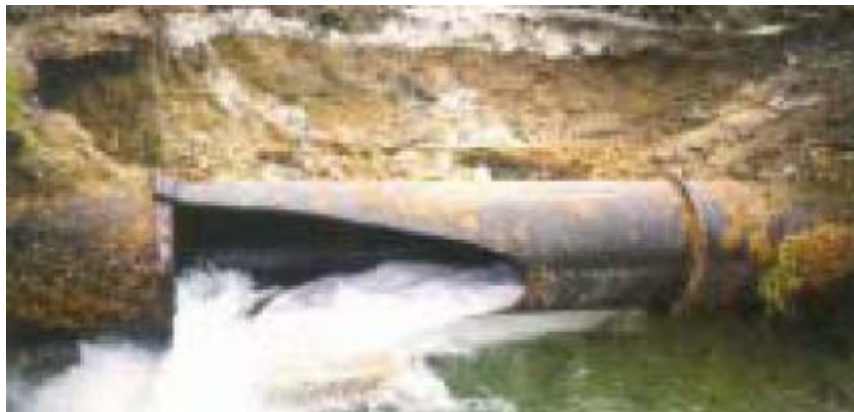
Rotura de tubería de fundición por exceso de presión. Posiblemente unido a presencia de aire atrapado
