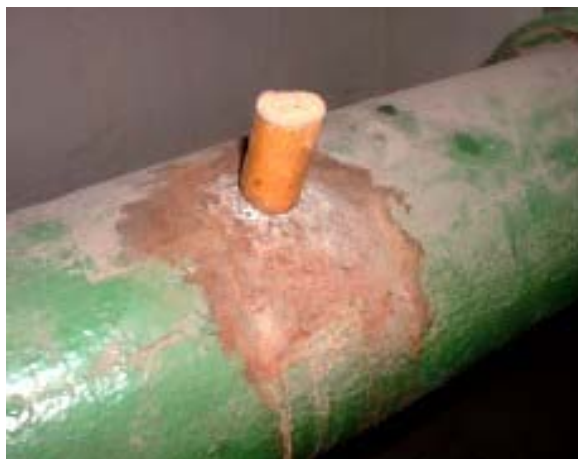
Corrosión de tubería de fundición por comportamiento anódico de la misma. Tubería conectada mediante bridas no aisladas convenientemente
