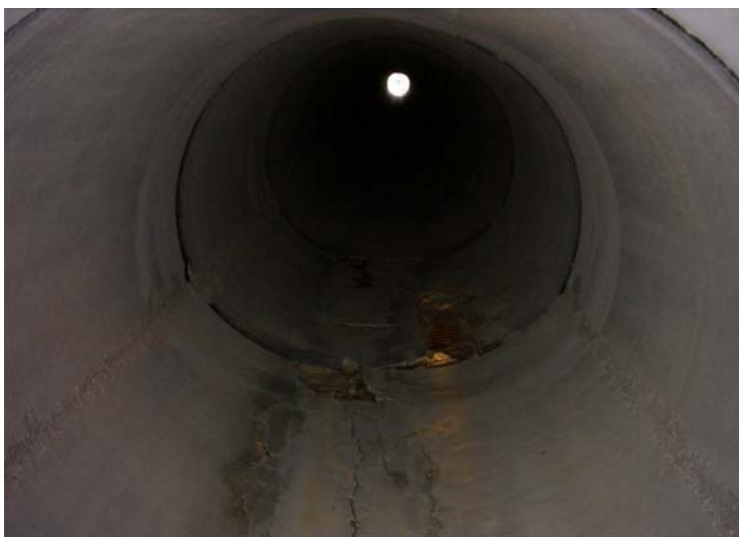
Error en cálculo mecánico de la tubería. Tubería de hormigón de \phi 1800
