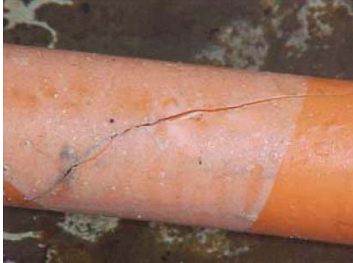
Rotura por exceso de presión en tubería de PVC
