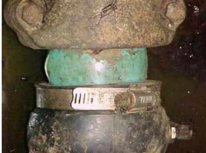
“Típica” chapuza de conexión entre distintos materiales sin emplear piezas estandarizadas
