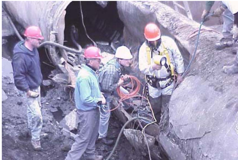
Tubería de acero revestida de hormigón que ha colapsado interiormente por depresión interior
