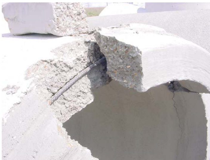
Boquilla de tubería de hormigón. Se detecta la falta de armadura en toda la boquilla
