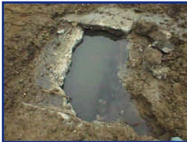
Corrosión de la clave de tubería de hormigón por presencia de sulfuro de hidrógeno
